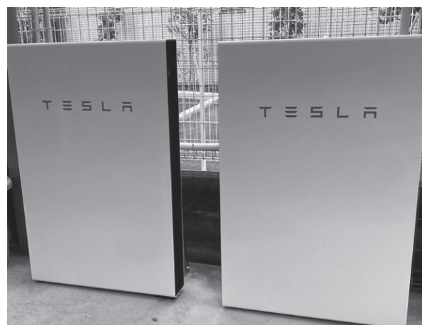
図7 川崎市A様宅 テスラ蓄電池「パワーウォール」13.5kWh×2台 (10台まで連結可能) 設備
