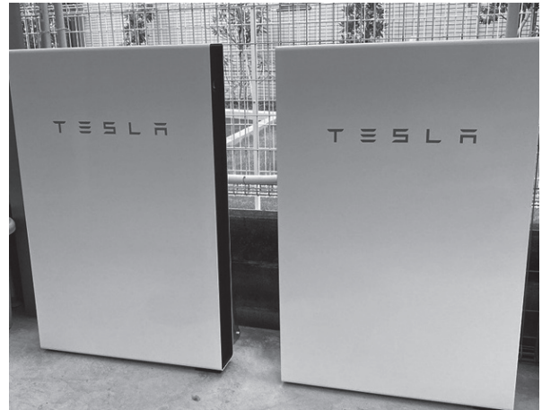
図7 川崎市A様宅 テスラ蓄電池「パワーウォール」13.5kWh×2台 (10台まで連結可能) 設備
