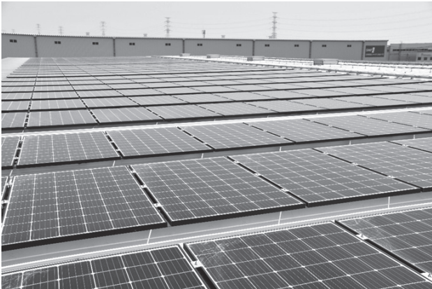
図6 工場屋上 自家消費型太陽光発電設備
